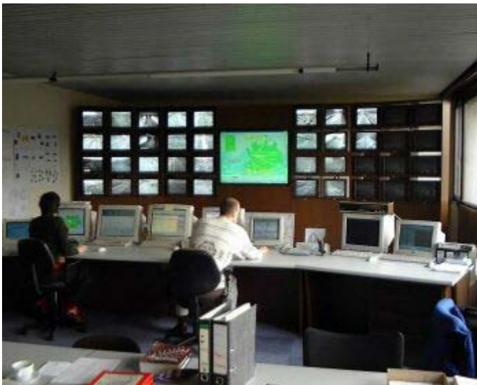
Figuur 3: De videowall van het Vlaams Verkeerscentrum
